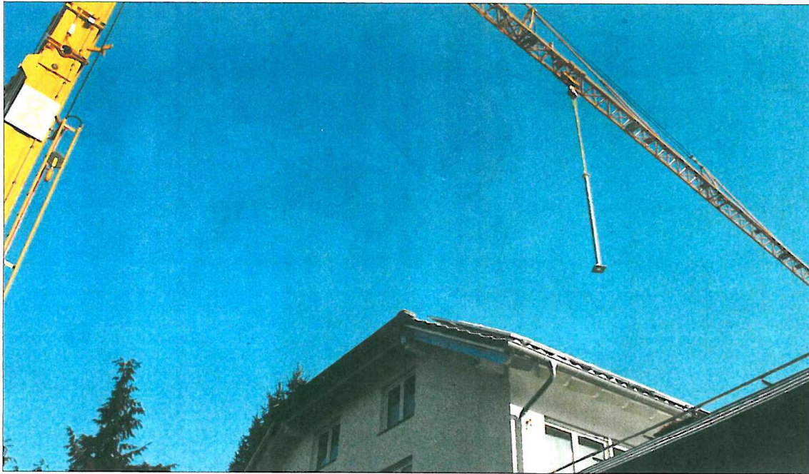
An einem rund 1,50 Meter langen Pfosten wird die Turbine montiert. Per Kran mussten die Einzelteile aufs Dach gehievt werden. Foto: Mayer
